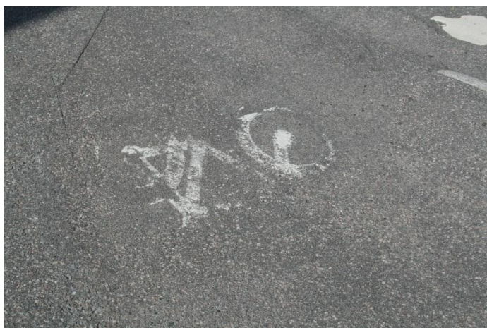
Utnött vägmålning är vanligt förekommande i kommunens cykelvägnät.
