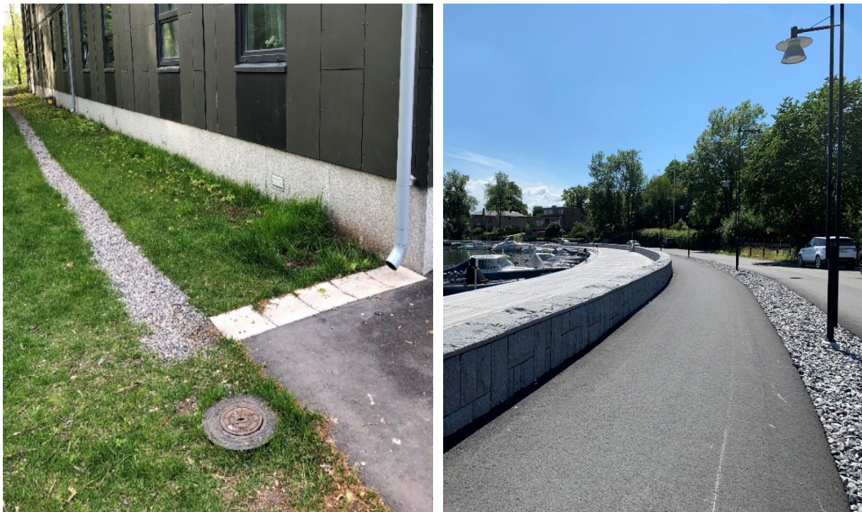
Figur 11. Makadamdiken kan anläggas både på kvartersmark samt allmän platsmark. T.V. visas fördröjning av takvatten från ett flerbilshus i Stockholm (Foto: Bjerking). T.H. är ett makadamdike mellan väg och gång- och cykelbana i Samsjövik i Danderyds östra delar (Foto: Danderyds kommun).
